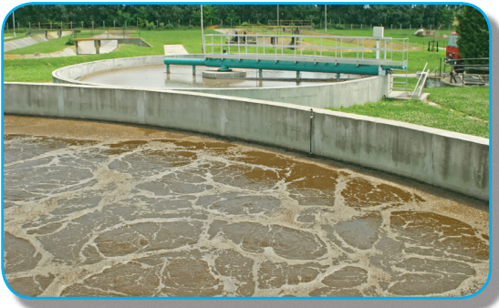
Service Eau et Assainissement
