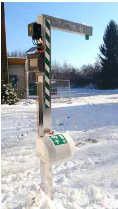
Notdusche im Winterbetrieb / Safety shower in wintertime
